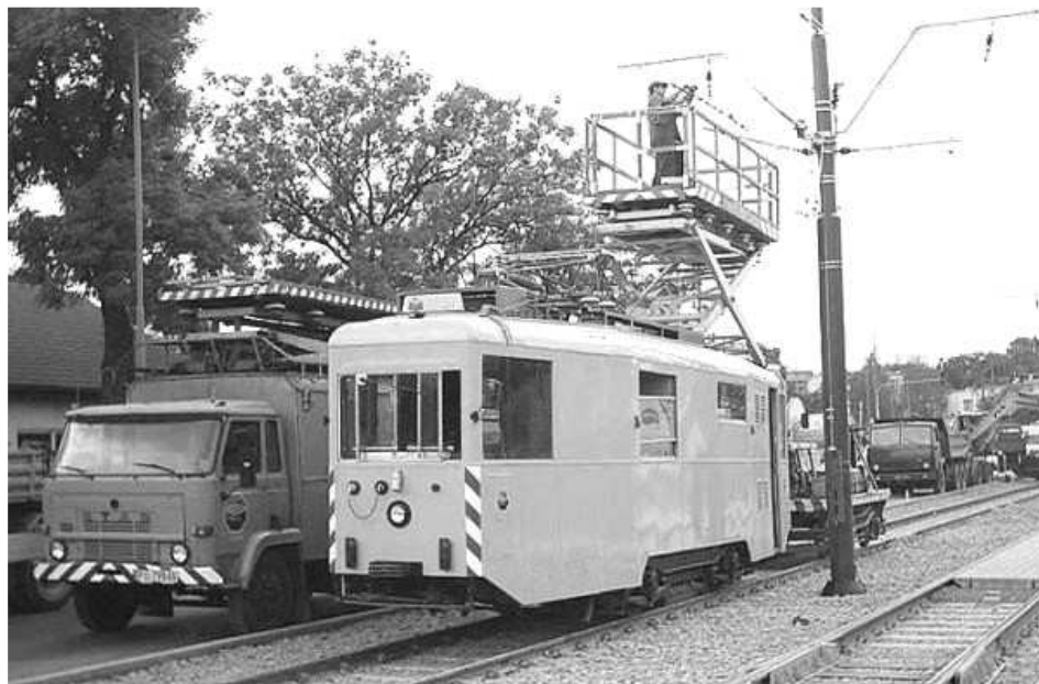
Montaż sieci trakcyjnej na ul. Grunwaldzkiej przy wykorzystaniu wyremontowanego wagonu nr 2041. Fot. Maciej Rudzki, 12.08.2003 r.
